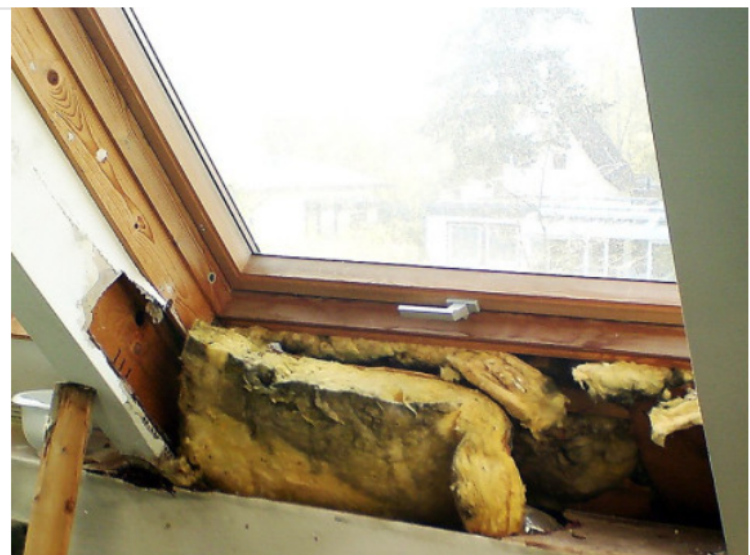
Последствия попадания влаги в кровельный пирог крыши.
